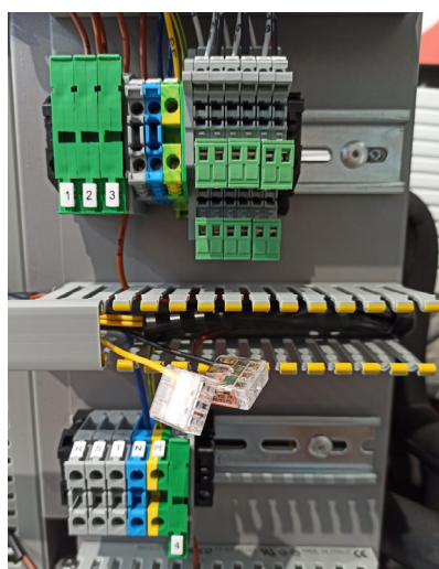
③ Particolare canalina
