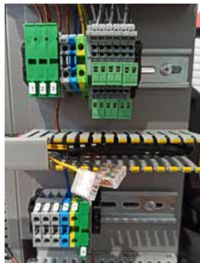
③ Particolare canalina
