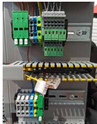
③ Particolare canalina
